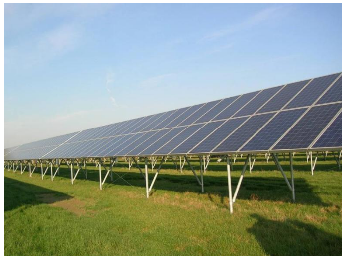
Εικόνα 3-9. Μεταλλική βάση στήριξης φωτοβολταϊκών πλαισίων πακτωμένη επί του εδάφους
