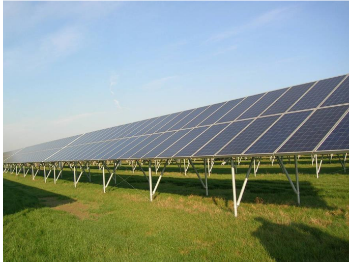
Εικόνα 2-6. Μεταλλική βάση στήριξης φωτοβολταϊκών πλαισίων πακτωμένη επί του εδάφους
