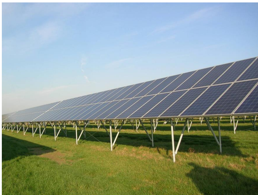
Εικόνα 6.7.: Μεταλλική βάση στήριξης φωτοβολταϊκών πλαισίων πακτωμένη επί του εδάφους
