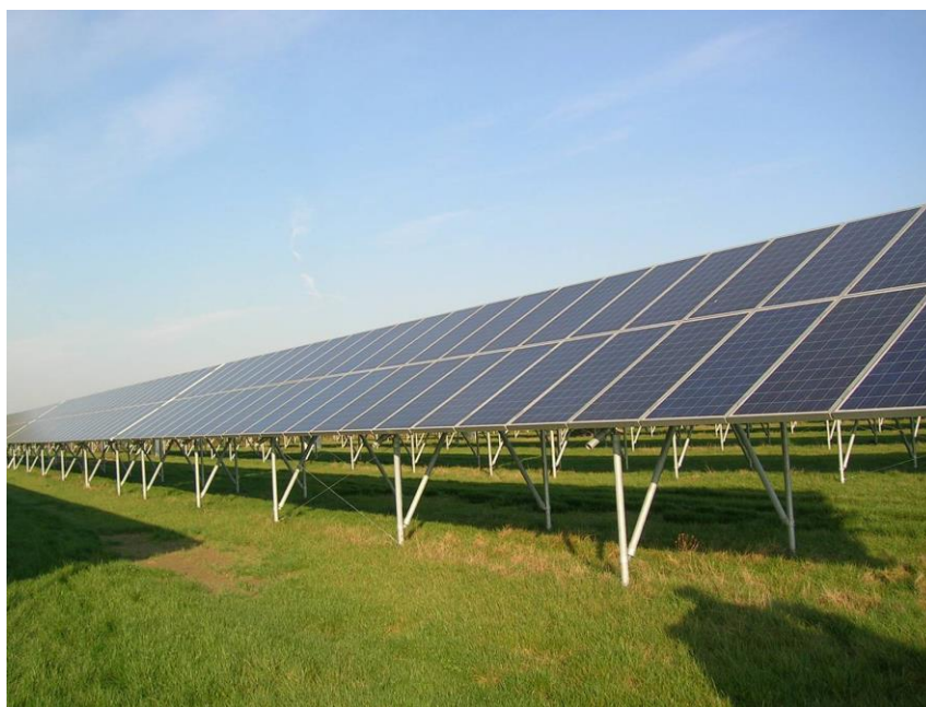
Εικόνα 6.7.: Μεταλλική βάση στήριξης φωτοβολταϊκών πλαισίων πακτωμένη επί του εδάφους
